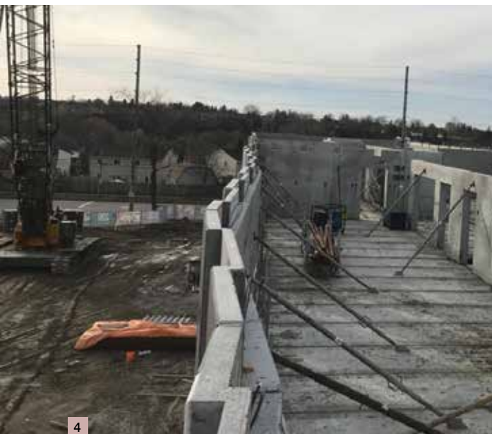
Plan view of angled exterior precast concrete wall / Vue en plan du mur extérieur angulaire de béton préfabriqué
